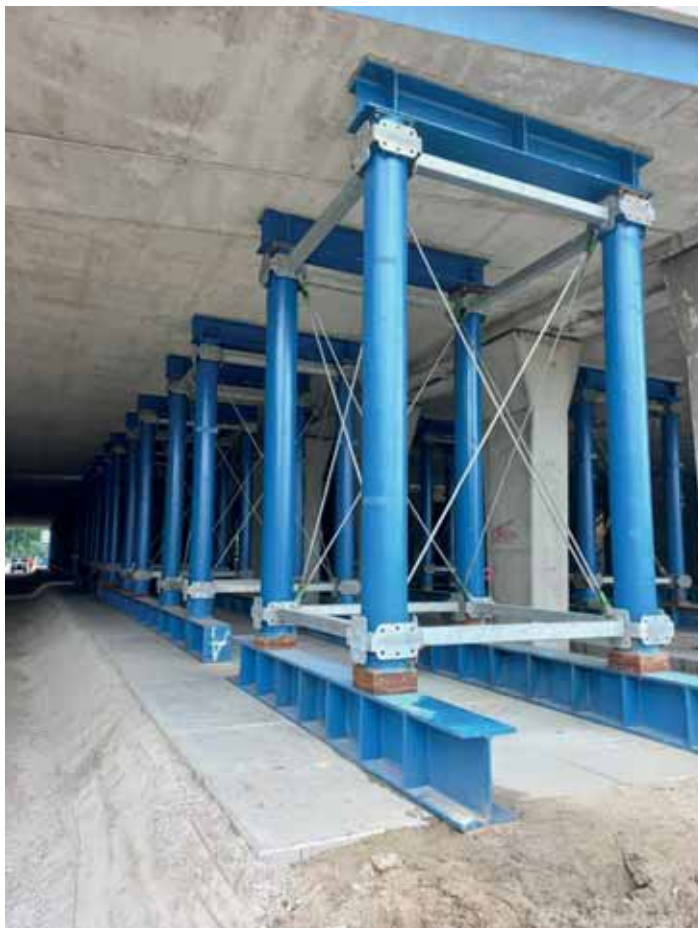
6 Viaduct Hoofdweg op de 'intensive care' foto: Rijkswaterstaat
