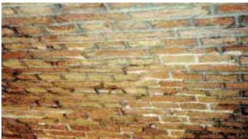
12 Schade a.g.v. sulfaat
