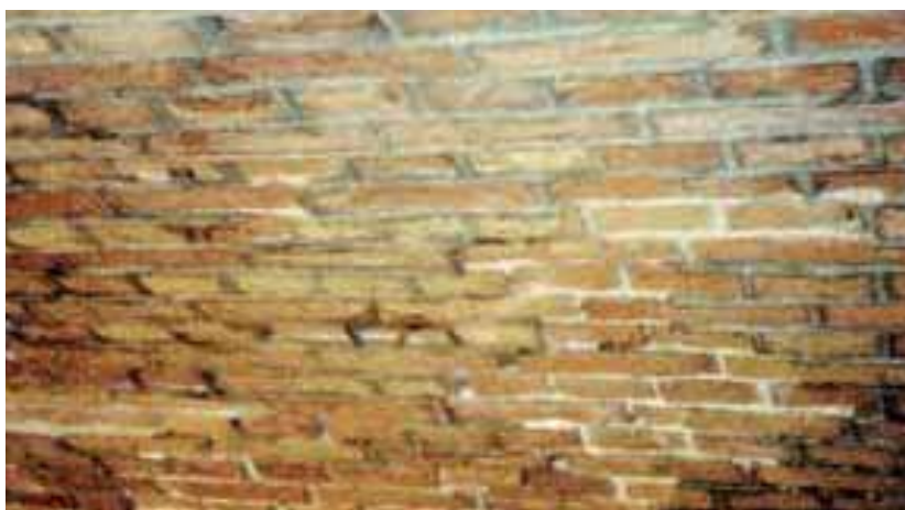
12 Schade a.g.v. sulfaat
