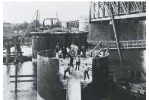
10 Militairen van de spoorwegtroepen slopen de pijlers van de oude spoorbrug bij Westervoort. Op de achtergrond zijn de bogen van de oude spoorbrug nog zichtbaar. Links de restanten van een houten ijsbreker.
