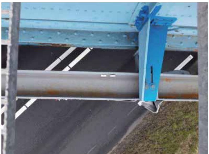
Sensor op de aanrijbalk van de brug
