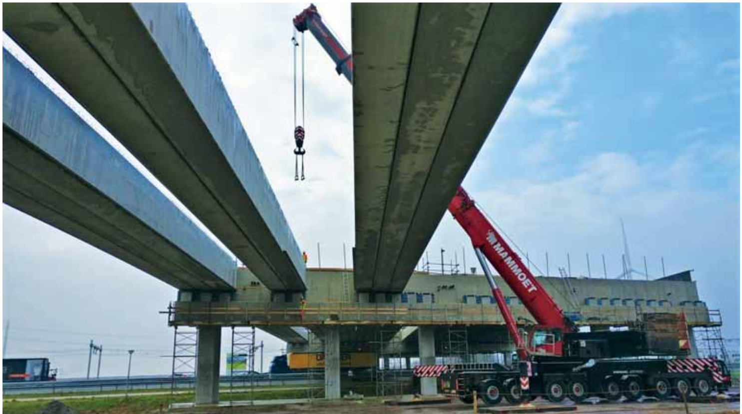
Tussensteunpunt is asymmetrisch belast in bouwfase.
