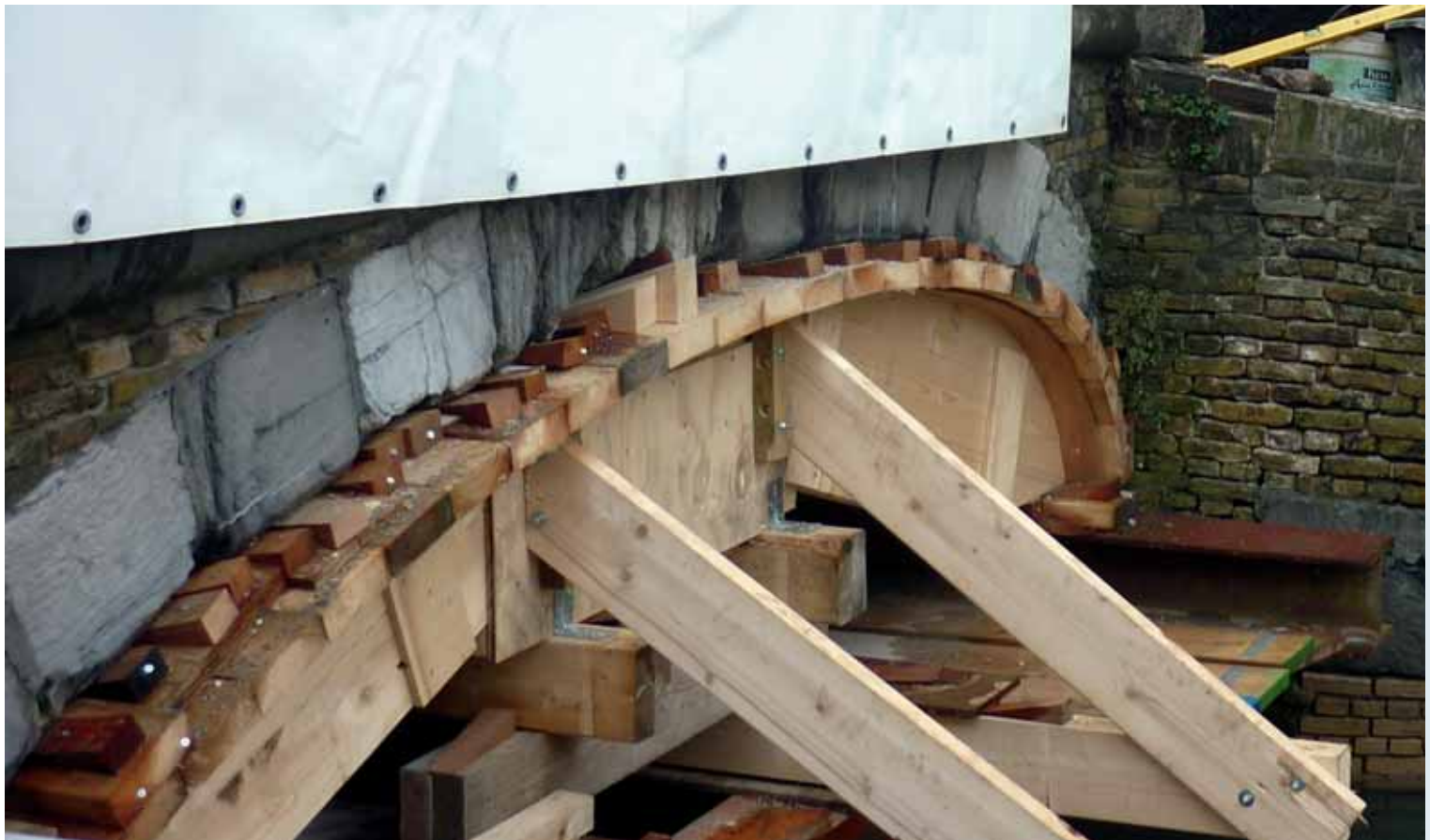
↑ Ondersteuning van de hardstenen toeg op een formeel tijdens de restauratie (bron: Van der Ven).
