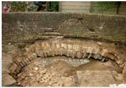
↑ Havensluisbrug met ingestort gewelf en gescheurde binnendijkse borstwering.
