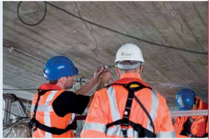
2 Sensoren en scheurvorming onderzijde brug
