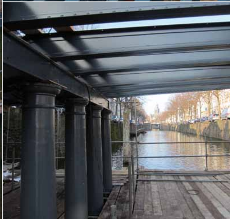
Afb. 7. en 8. De nieuwe liggers zijn van constructiestaal model conform de originele tekeningen
