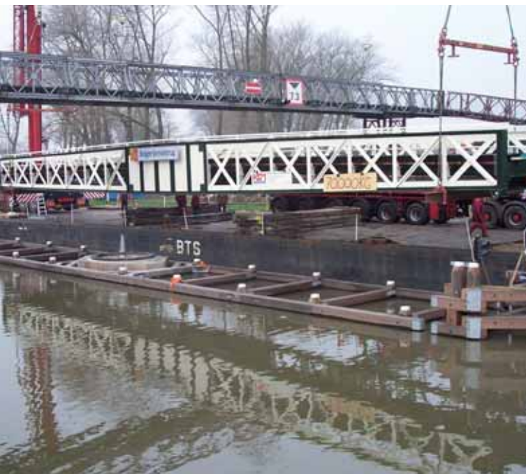
afb. 4 De brug in de takels tijdens de montage met op de achtergrond de tijdelijke loopbrug
