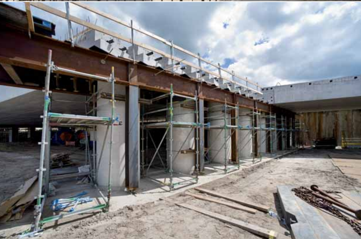
Boven: "In de takels"; met twee mobiele kranen worden de liggers op hun plaats gebracht Onder: Liggers geplaatst op de tijdelijke hulpondersteuning
