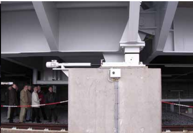
6. Brug opgevijseld, speling boven oplegging.
