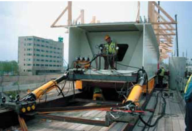
Duwvijzels en bedieningsruimte.
