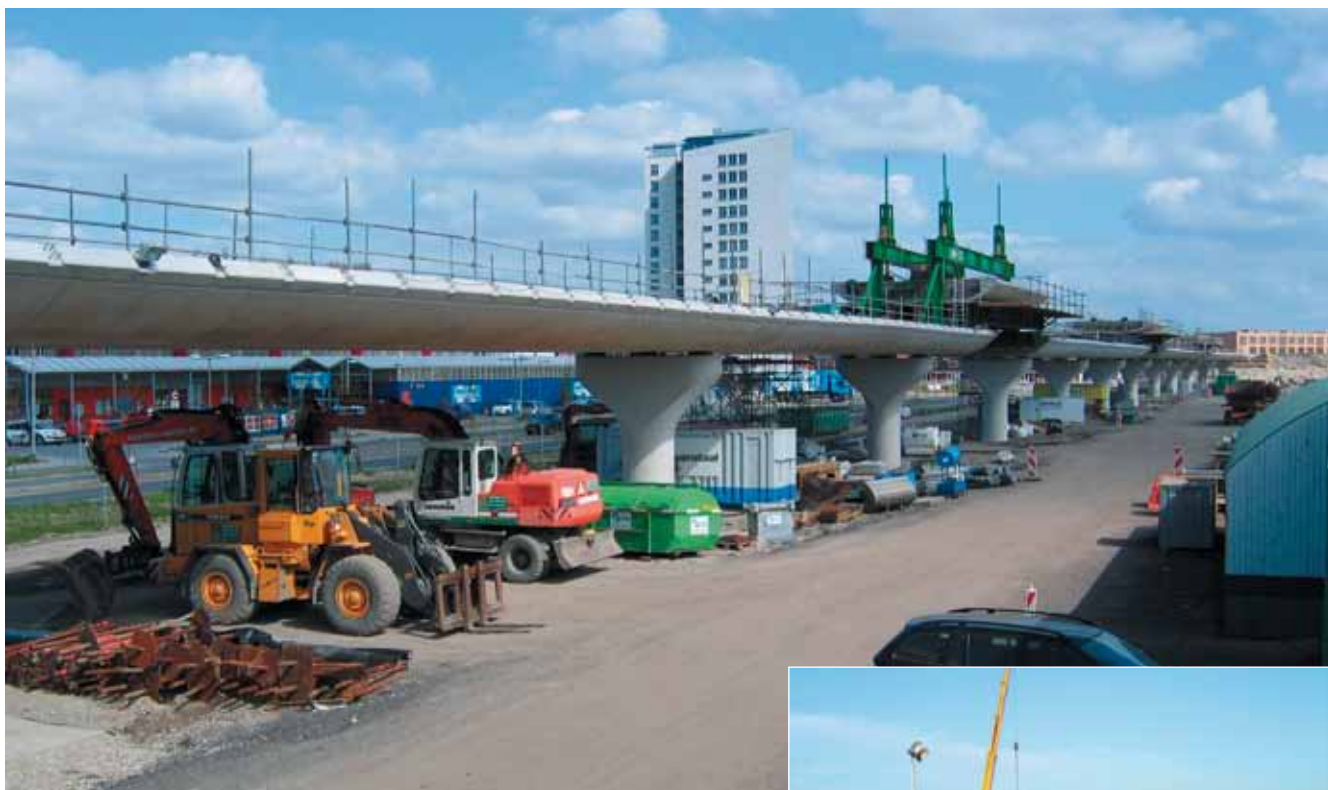
Boven: Hooggelegen voorgespannen beton viaduct rechts: Opschuiven van de bekisting van het betonviaduct
