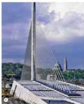
1 Pont de la Pape in Liège, bevestiging van de toren op het roosterdek. [Foto: Shashu]
